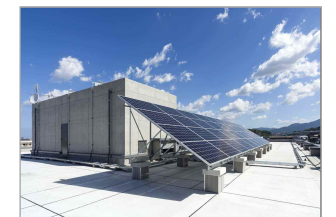
再生可能エネルギー施設 (太陽光発電施設 等)
