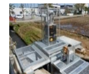
小水力発電施設
