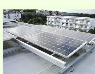
太陽光発電関連設備の設置
